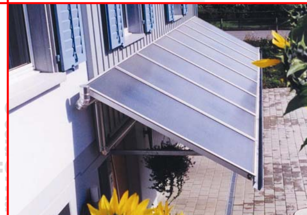
Kollektoranlage an Hausfassade © SSES
