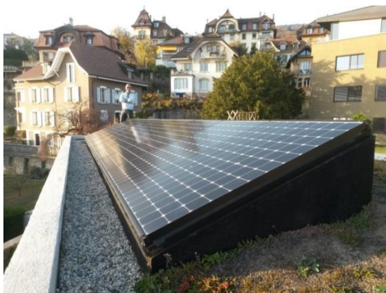
Installation de 3.0 kWc en ville de Neuchâtel, réalisée par un membre d'Autovoltaic
