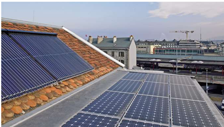
Die thermischen Röhrenkollektoren und die Photozellen nebeneinander auf dem Dach.
