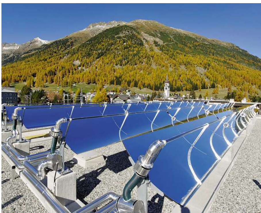
Die Solaranlage mit parabolrinnenförmigen Kollektoren ist ein Pilotprojekt.
