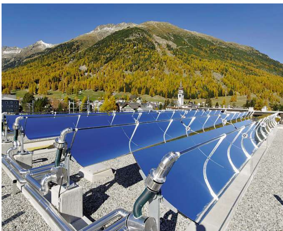
Cette installation solaire constituée de capteurs paraboliques est un projet pilote.
