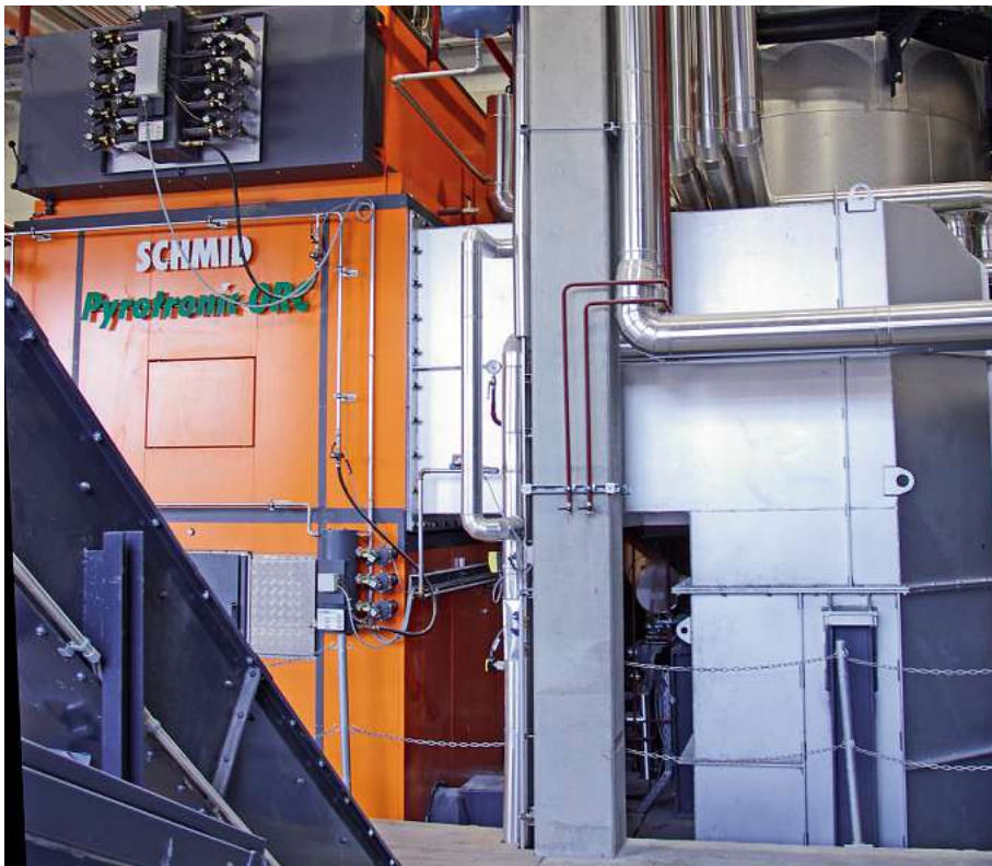
Feuerung mit Thermoöl-Kessel (rechts)
