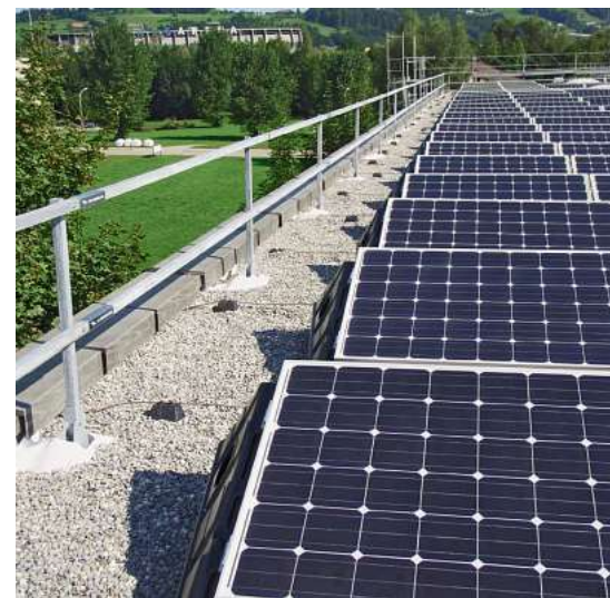
Protection collective pour l'entretien: barrières de sécurité rabattables.
