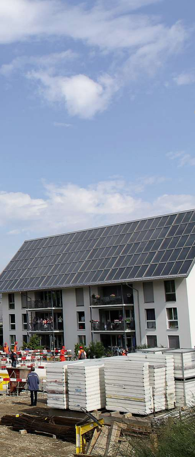
Bild: Jenni Energietechnik AG
