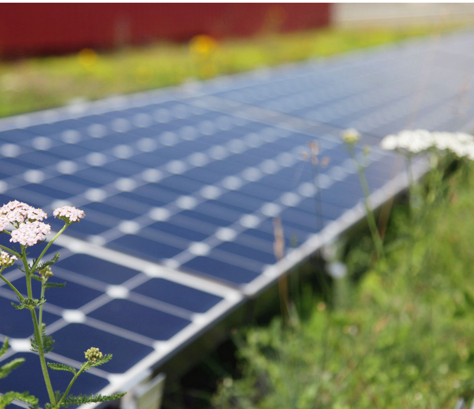
Installation PV de l'IEFE à la ZHAW School of Engineering à Winterthur.
