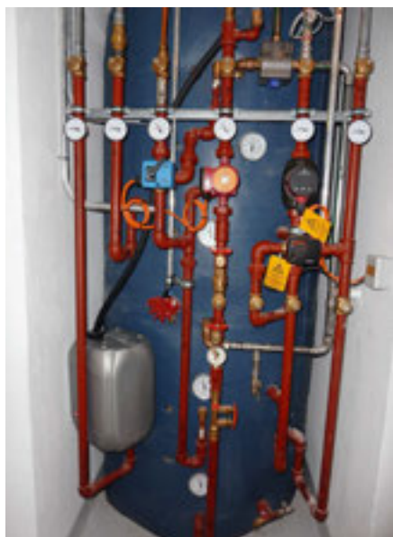
Hier sind die Siphons erkennbar. Das Foto wurde vor der Dämmung der Leitungen aufgenommen.
