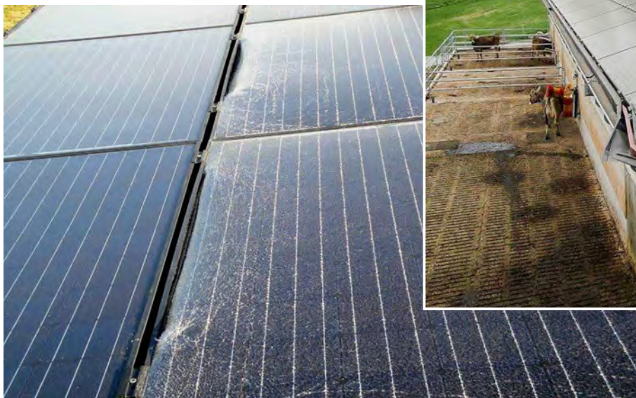
Après les dégâts survenus l'avant-dernier hiver (à droite), des modules ont à nouveau été endommagés l'hiver suivant.
