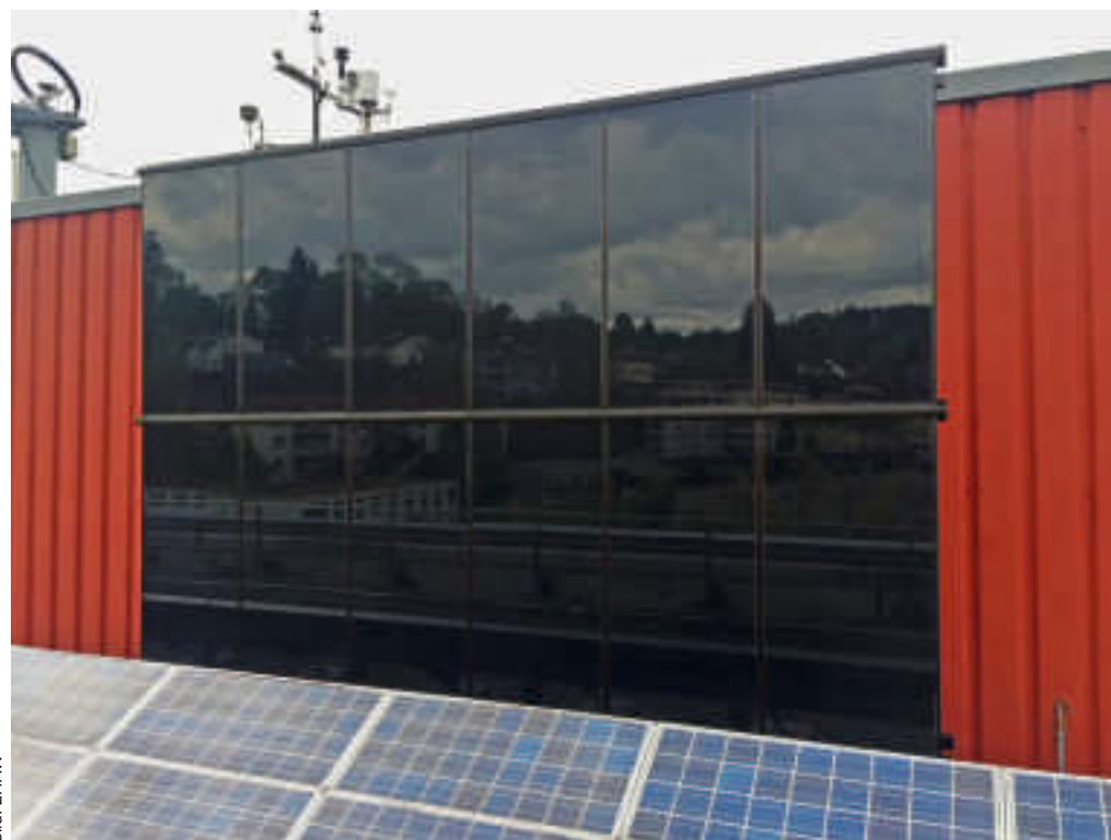
Hinter den Panels verstecken sich Wechselrichter, Wärmepumpe und Wasserspeicher.
