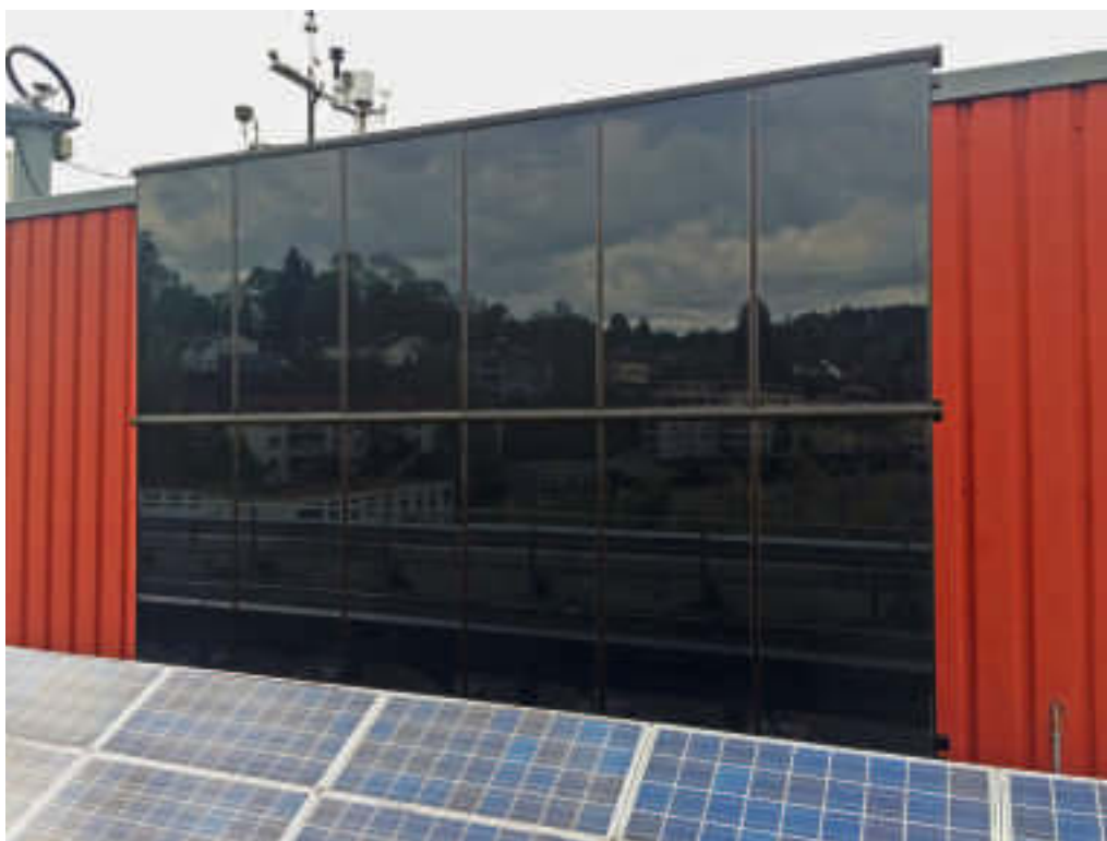
Derrière les panneaux se cachent onduleur, pompe à chaleur et réservoir d'eau.
