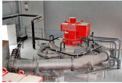
Unbestritten ist die Förderung zur Stromerzeugung bei Trinkwasser- oder Abwasserinfrastrukturen. Anfang 2014 wurden die KEV-Mindestbeiträge dazu erhöht.
