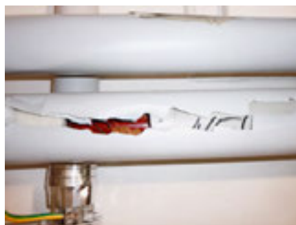
Altes bröseliges Dämmmaterial mit neuer PVC-Umhüllung – so nicht!
