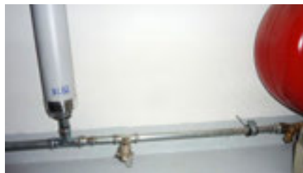
Es fehlt die Dämmung auf der linken Seite.
