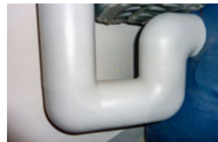
Vorbildlich gedämmter Siphon.
