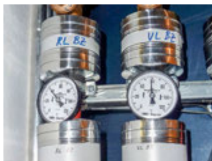
Anlegethermometer ohne Abstandssockel: Es konnte nicht gedämmt werden, die Stellen blieben ausgespart.
