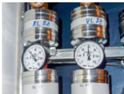
Isolation impossible: thermomètre sans connection avec soubassement.
