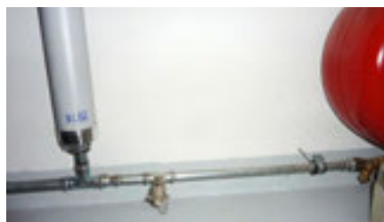
Il manque de l'isolement sur la partie gauche.
