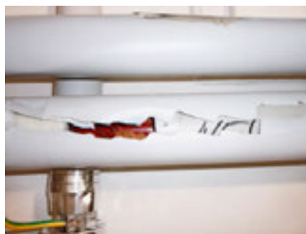
Le vieux matériel d'isolation a été recouvert par une gaine en PVC.
