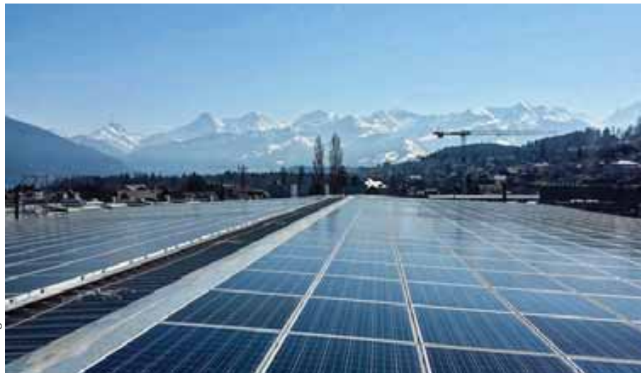
Bild: Energie Thun
