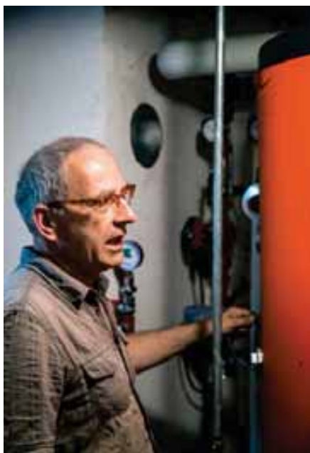
Die Anlagenteile im Haus begutachtet Markus May im Gespräch mit den Eigentümern.
