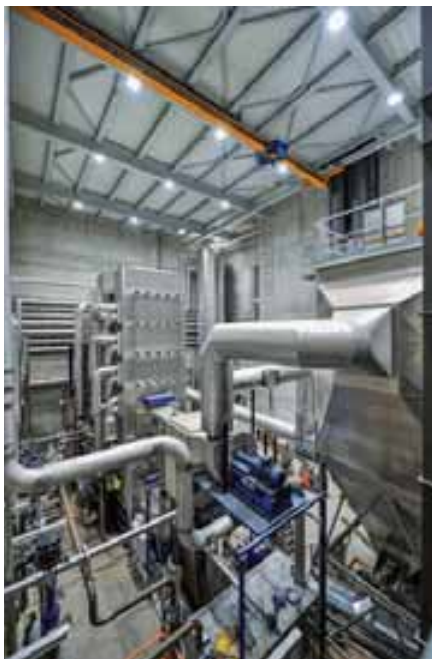
Heizzentrale des Coop-Verteilzentrums in Schafisheim: hinten im Bild der turmartige Aufbau des Wärmetauschers, in dem das Thermoöl für die Backlinien mit dem Verbrennungsgas der Biomassefeuerung erhitzt wird. Vorne rechts: der Elektroabscheider, der den Feinstaub aus der Abluft entfernt.
