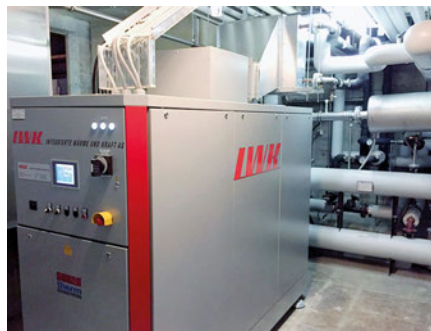
Le groupe chaleur force (CCF) 125 kWth 70 kWél avec, sur le dessus, le récupérateur de la chaleur de refroidissement dégagée par l'enveloppe du moteur et la génératrice.
