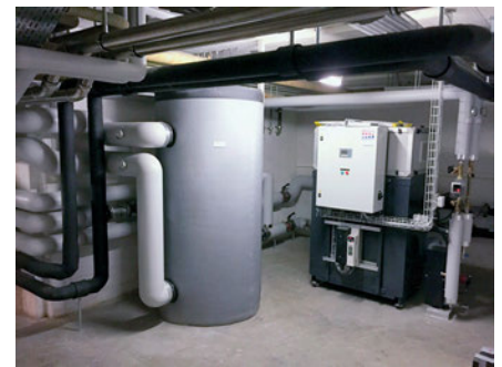
La pompe à chaleur de 65 kWth et l'accumulateur de chaleur tampon à gauche.
