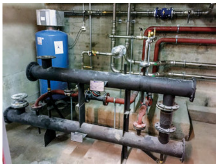
Les condenseurs des gaz de fumée du couplage chaleur-force. En bas, le condenseur est raccordé sur le retour du chauffage, en haut, sur l'accumulateur saisonnier et l'évaporateur de la pompe à chaleur.
