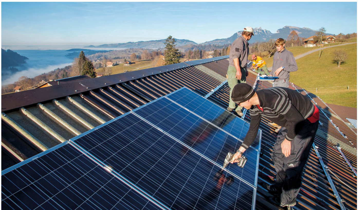
Das gemeinsame Arbeiten auf dem Dach gehört zum Selbstbau mit der Energiewendegenossenschaft Spiez dazu.
