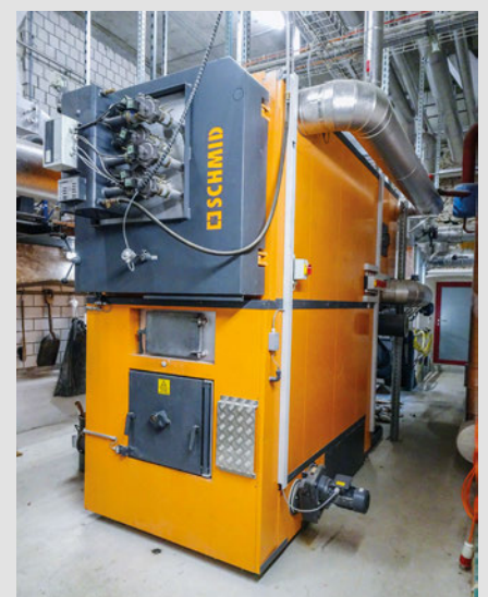
Die Vorschubrostfeuerung mit 550 kW Leistung vermag auch minderwertige Schnitzelqualitäten problemlos zu verfeuern. Bild: Holzenergie Schweiz
