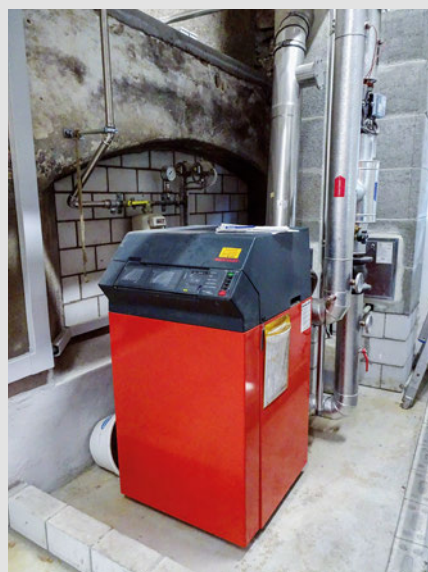
Der Biogaskessel erzeugt vor allem im Sommer das Warmwasser. Bild: Holzenergie Schweiz
