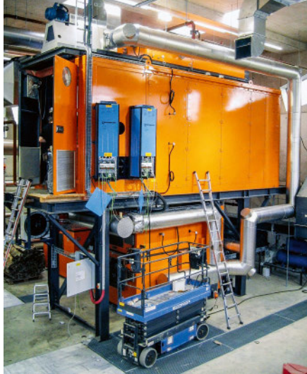
L'installation de couplage chaleur-force avec turbine à air chaud dans la centrale énergétique de chaleur à distance de Guin (FR)
