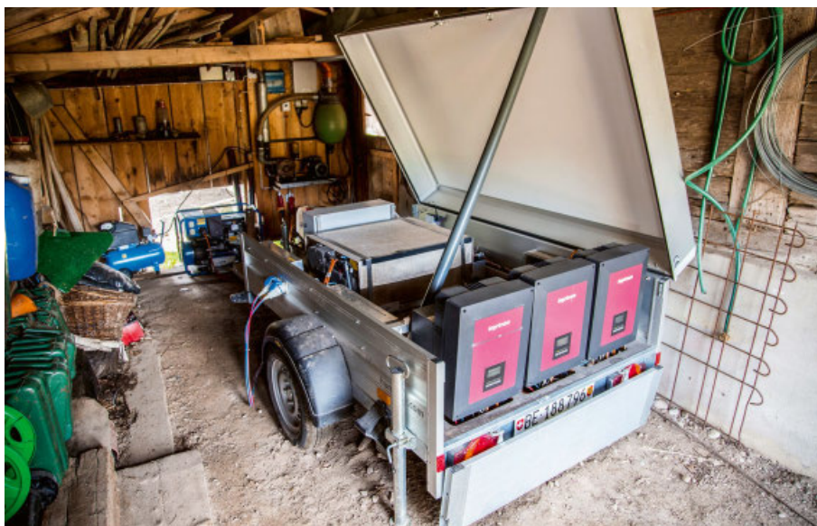
Der vom Meiringer Max Ursin entwickelte Batterieanhänger IndieWatt liefert mit seinen drei Wechselrichtern und der Salzatterie den benötigten Drehstrom für die Anlagen auf der Alp.
