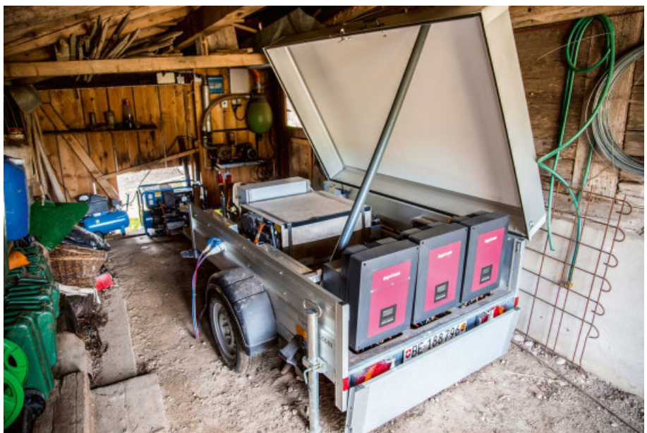
La remorque à batterie Indiewatt, développée par Max Ursin de Meiringen, offre le courant alternatif nécessaire à l'exploitation avec ses trois onduleurs et sa batterie au sel.
