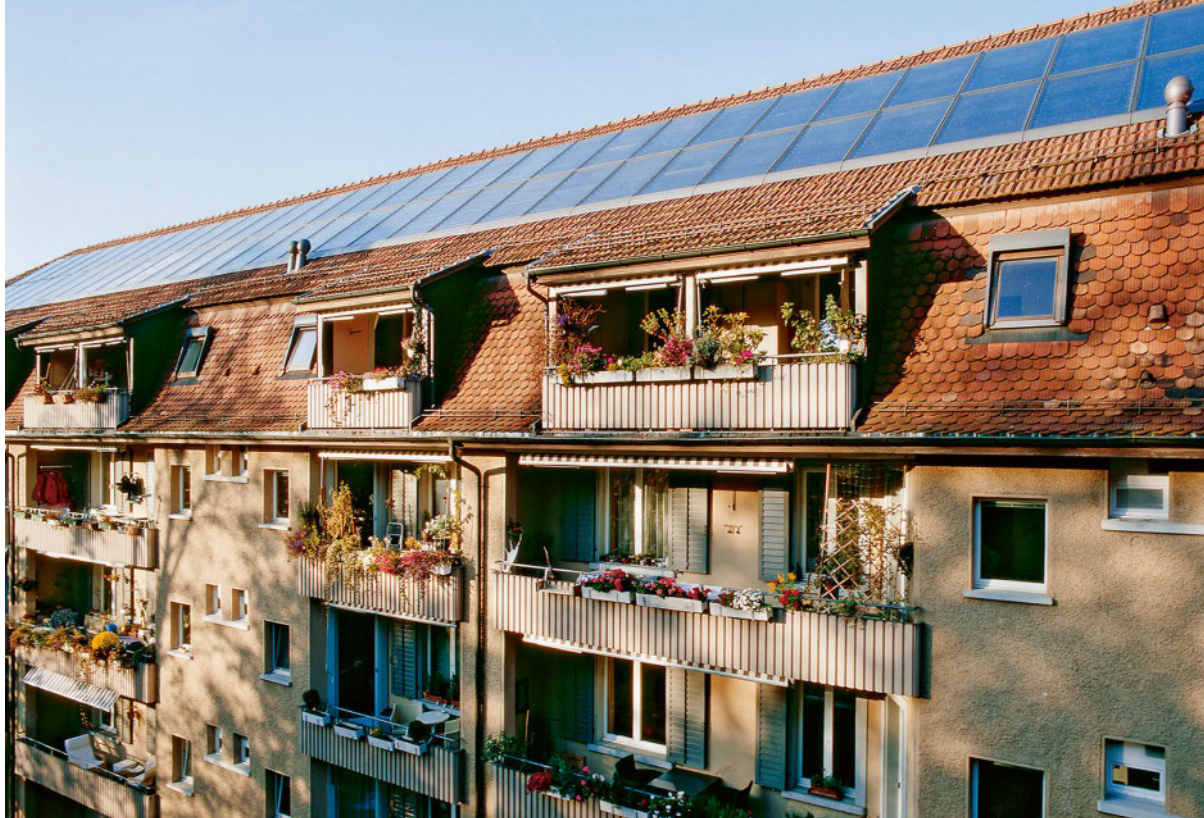
Die Überbauung an der Hammerstrasse 102 in Zürich zeigt, wie Sonnenkollektoren gut in eine Dachfläche integriert werden können.
