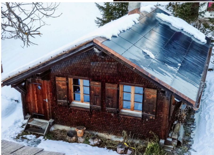
← FIG. 3: DÈS 2015, « PHASE 3 » La nouvelle installation (monocristalline) est intégrée à la toiture. Ses modules n'ont pas de cadre qui freine la neige. Cinq crochets plats les maintiennent sur leur bord inférieur. La rangée supérieure est équipée de modules factices, ce qui permet d'éviter d'installer de coûteux modules sur mesure. De plus, si de la neige reste sur la faite du toit, elle ne touche pas de modules actifs.
