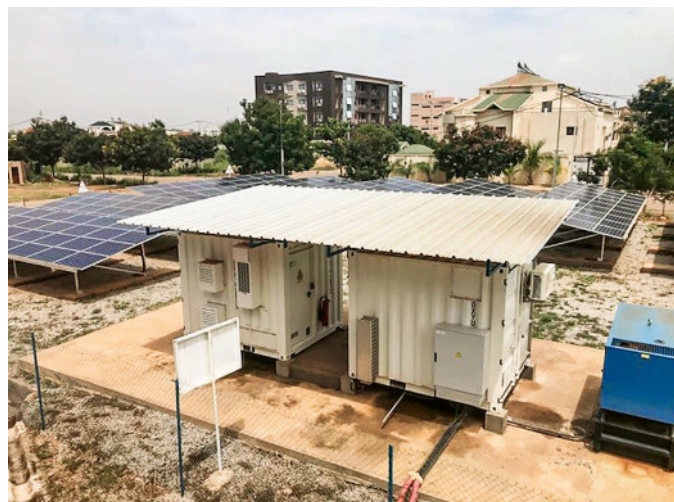
Eine Solarstromversorgung mit Batterien für ein Kino im wohlhabenden Quartier Ouaga 2000.
