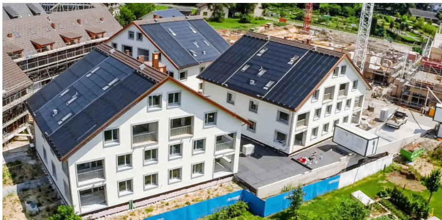
Drei Mehrfamilienhäuser (23 Wohnungen) in Mettmenstetten hat die Firma énergie solaire (Sierre [VS]) 2016 mit Sonnenkollektoren (an den Dachrändern) und PV-Modulen (in der Mitte) ausgestattet. Zur Erdsondenregeneration wird Überschusswärme im Sommer ins Erdreich eingebracht. Jedes Haus verfügt über 110 m 2 unverglaste thermische Kollektoren für den Niedrigtemperaturbereich. Das ist nötig, um das Erdreich nicht zur überhitzen.
