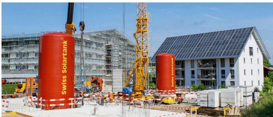
Ein Swiss Solartank von Jenni Energietechnik (Burgdorf) mit 108 000 Litern Volumen auf dem Transport zu einem Sechsfamilienhaus in Huttwil. Der zehn Meter lange Speicher deckt zu 100 Prozent den Wärmebedarf der Bewohner für Brauchwasser und Heizung.
