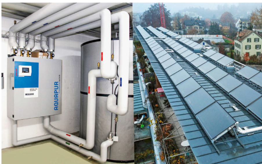
Auf dem Dach der Wohnsiedlung Werk 1, Uster: Aquapur-Systeme von Soltop (Elgg [ZH]) sind die Warmwasserlösung für Mehrfamilienhäuser und Anwendungen mit erhöhtem Hygienebedarf wie Altersheime oder Spitälern. Die einfache Technik mit Solarthermie ist servicefreundlich und einfach auszulegen.
