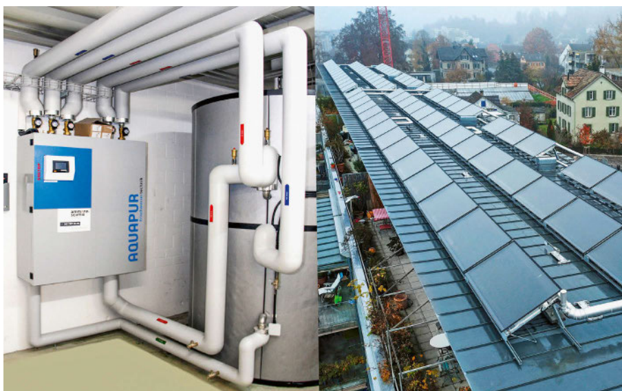
Sur le toit du lotissement résidentiel Werk 1, Uster: les systèmes Aquapur de Soltop (Elgg ZH) sont une solution pour la production d'eau chaude dans les immeubles et les établissements nécessitant un haut niveau d'hygiène, comme les maisons de retraite ou les hôpitaux. Cette technologie simple de solaire thermique est facile à entretenir et à installer.
