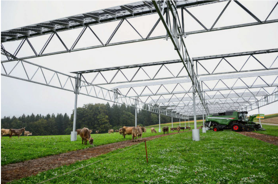
Die Installation steht weder den Traktoren noch den Kühen im Weg.
