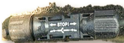
Fonte du corps du connecteur due à une connexion croisée
