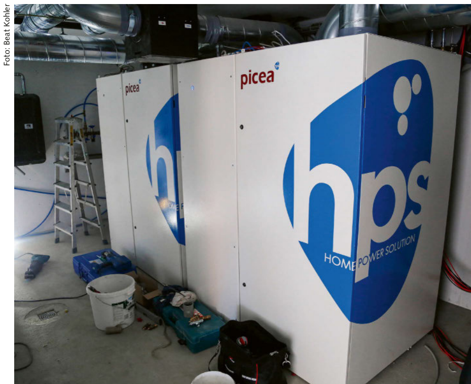
Das Picea-System, wie es hier zum Beispiel in einem Einfamilienhaus in St. Gallen installiert worden ist, verspricht, eine Versorgung mit selbst produziertem Strom über das ganze Jahr.
