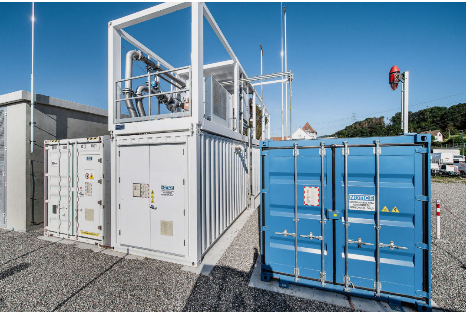
L'électrolyseur de Gösgen a commencé à produire de l'hydrogène.
