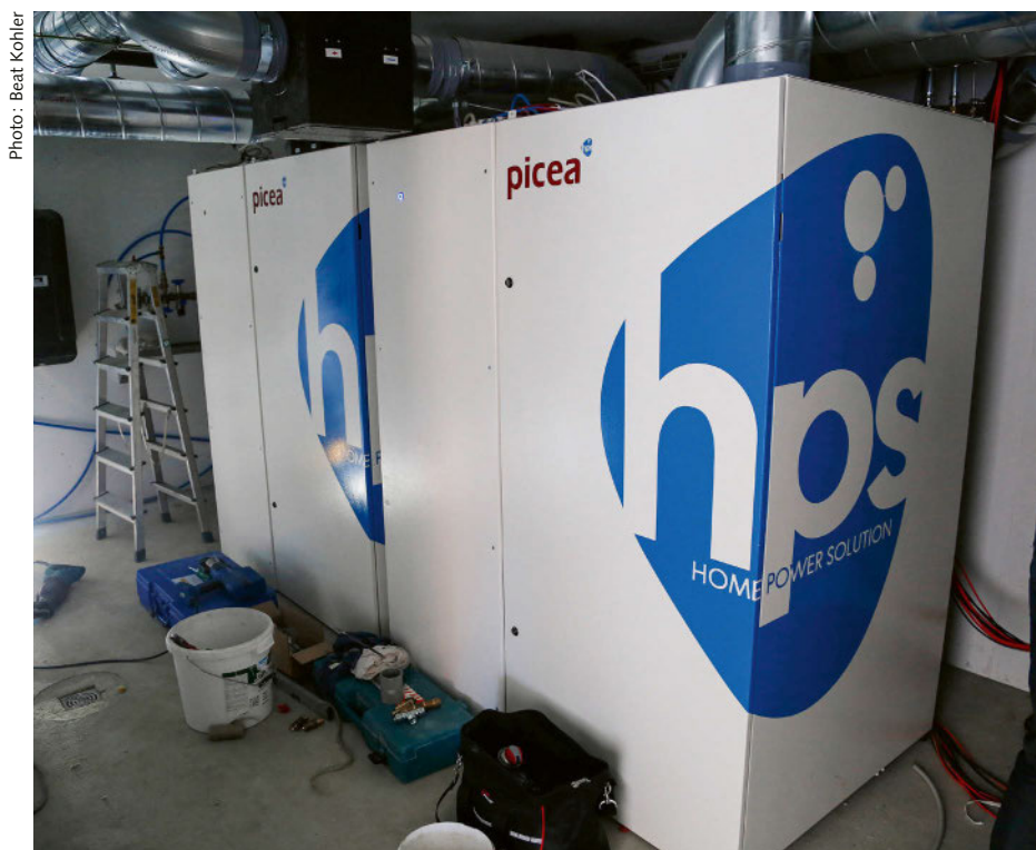
Le système Picea, tel qu'il a été installé par exemple ici dans une maison individuelle à Saint-Gall, offre un autoapprovisionnement en électricité tout au long de l'année.
