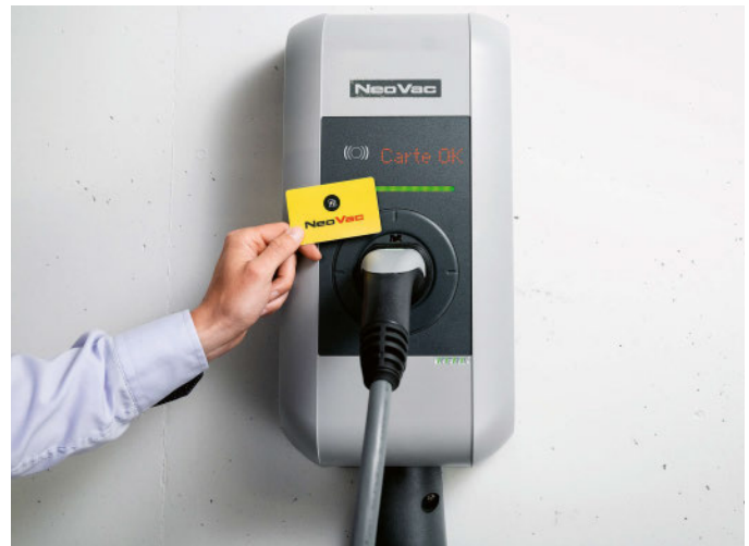
Les usagers s'identifient avec la carte RFID. Le décompte de la consommation d'électricité se fait automatiquement via le décompte individuel des frais d'énergie et d'eau.
