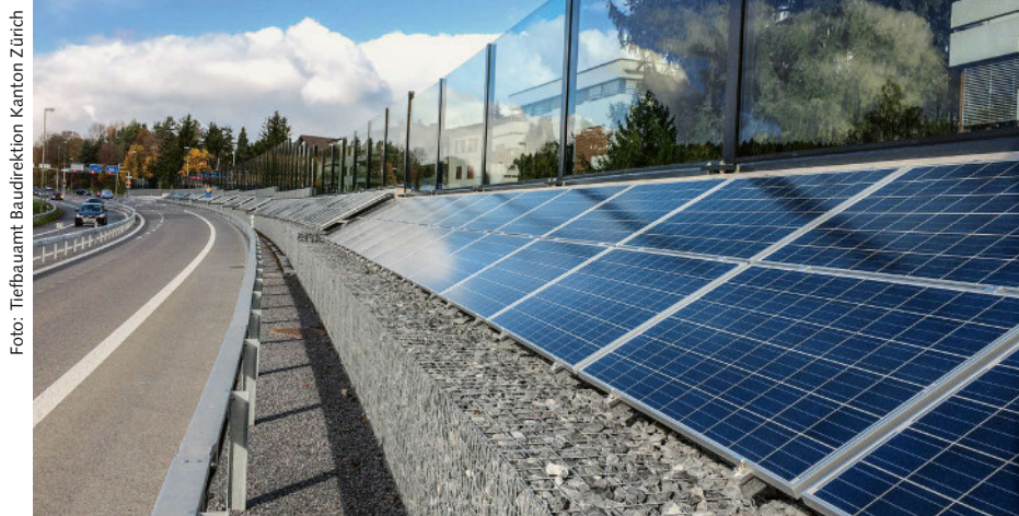
Foto: Tiefbauamt Baudirektion Kanton Zürich PV-Anlage an einer Lärmschutzwand, Autobahn Forch
