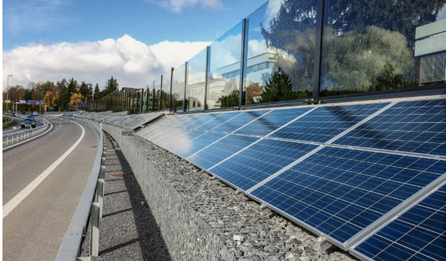
Système PV sur un mur antibruit, autoroute de Forch
