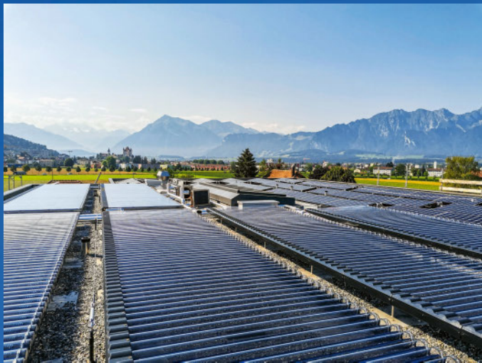
Das Mehrfamilienhaus Stuckimatte in Steffisburg (BE) wurde 2020 fertiggestellt. Es verfügt über eine 69 kW starke PV-Anlage, die jährlich rund 81 000 kWh produziert. Eine 115 m 2 grosse solarthermische Anlage liefert rund 34 500 kWh/a.
