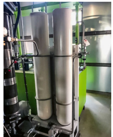
In diesen Druckflaschen wird die komprimierte Luft gespeichert, bis die Energie gebraucht wird.
