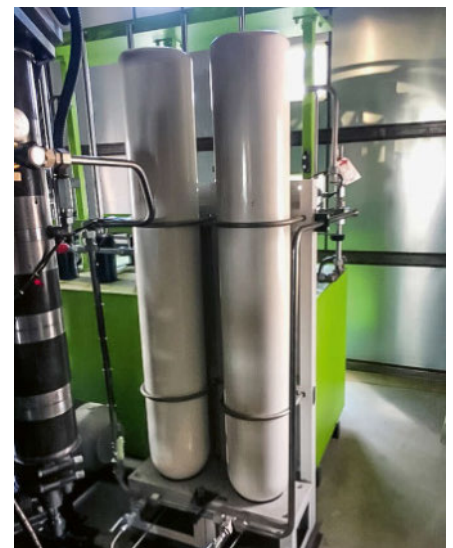
L'air comprimé est stocké dans ces bouteilles sous pression jusqu'à ce que l'énergie soit nécessaire.
