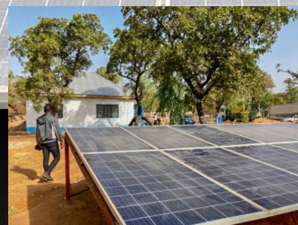
So sieht die Photovoltaikversorgung des Lycée Technique La Vision aus.
