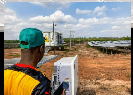
L'électricité est produite de manière fiable dans ce parc solaire de 20 MW au Ghana.
