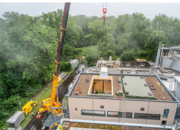
Der Elektrolyseur wurde mittels Kran durch das Dach in die Anlage in Dietikon gebracht.
