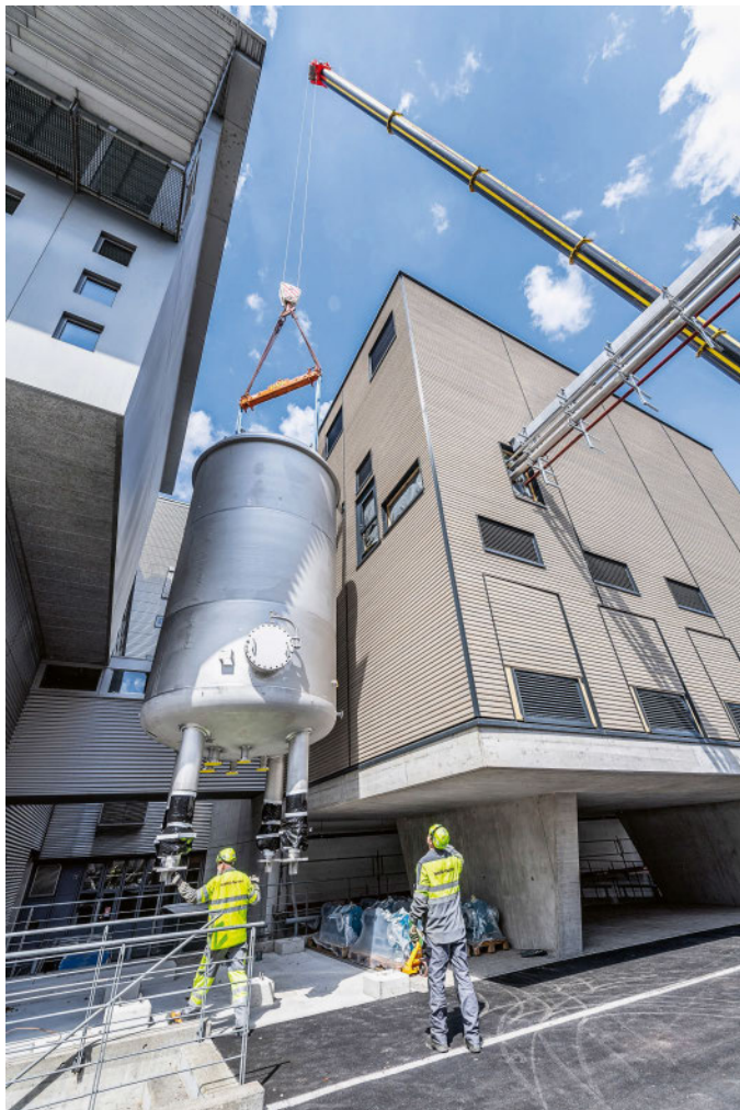
Wasserstoff wird zusammen mit Klärgas aus der ARA in diesem Methanisierungsreaktor von HZI Schmack, der hier installiert wird, im eigenentwickelten Verfahren in Methan umgewandelt.
