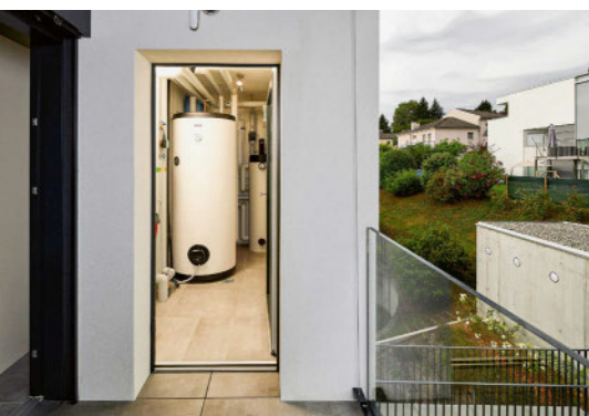
Blick in einen der vier Technikräume. Hier finden die Speicher für Heizung/Kühlung, Warmwasser sowie die Inneneinheit der Wärmepumpe Platz.
