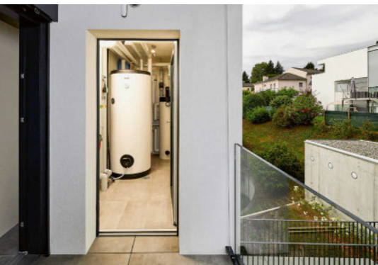
Vue de l'un des quatre locaux techniques. C'est là que se trouvent les accumulateurs pour le chauffage/la climatisation, l'eau chaude ainsi que l'unité intérieure de la pompe à chaleur.
