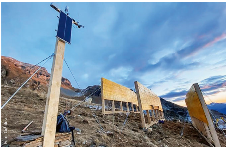
Seit dem 24. November 2022 steht auf Alperjüng eine Testanordnung für eine hochalpine Solaranlage in Betrieb mit drei Reihen von jeweils zwölf Metern Länge.
