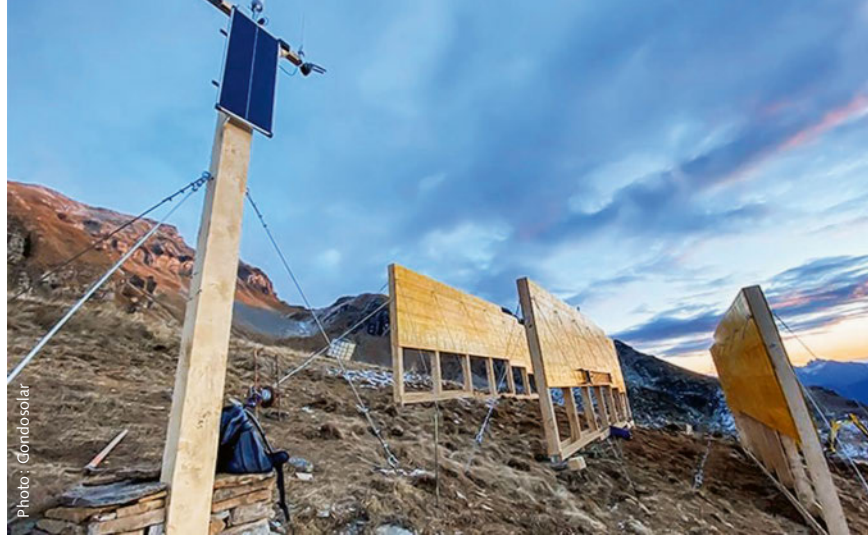
Depuis le 24 novembre 2022, un dispositif test pour une installation solaire de haute altitude est en service à Alplerung, avec trois rangées de 12 mètres de long chacune.
