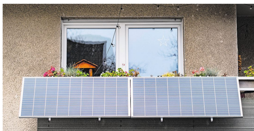
«Balkonkraftwerk» oder «Plug & Pay Anlage» sind schnell installiert. Bild: Imago Images
