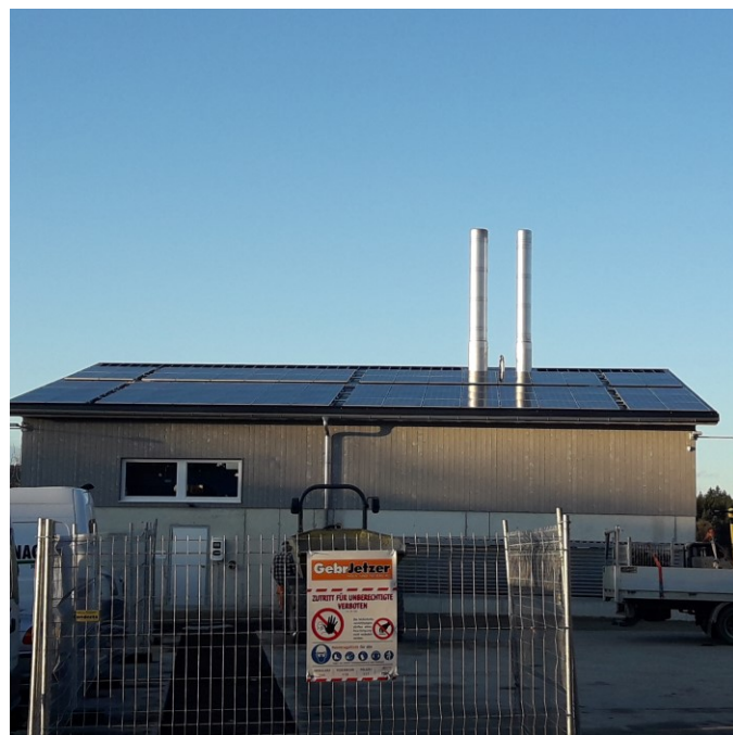
Bild 1: Fernwärmezentrale Uettligen mit PV-Anlage und öffentlicher Ladestation
