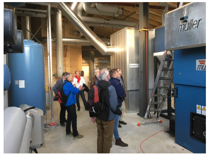
Bild 1: Besichtigung der neuen Fernwärmezentrale in Uettiligen vor der GV.
