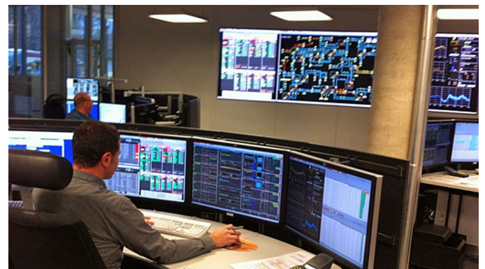
Bild 1: Leitstelle Energie ZLS, Zollikofen (SBB)
