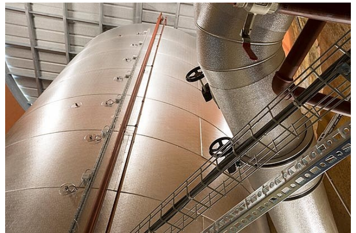
Bild 1: Speicher der Wärmезentrale Hinterkappelen
