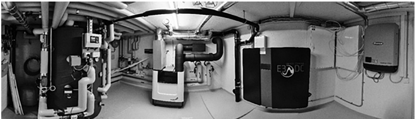
Solarspeicher mit Elektroheizung
