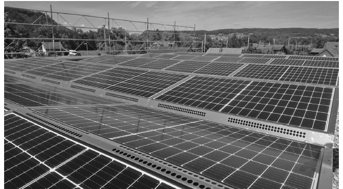
Solardach der Miloni Solar AG in Windisch
